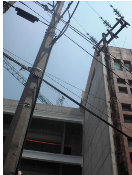
Postes de luz y teléfono
