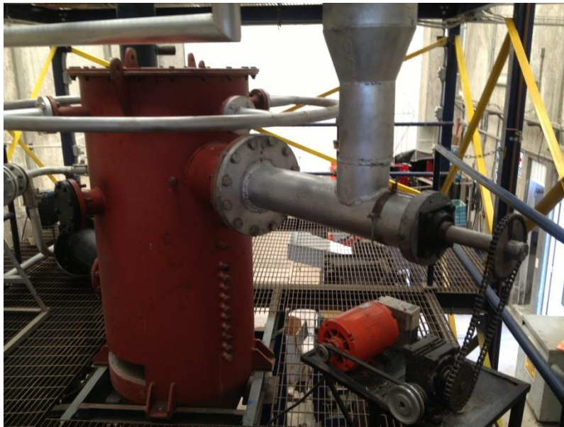
Figura 19. Vista del gasificador y el tornillo sin fin.
