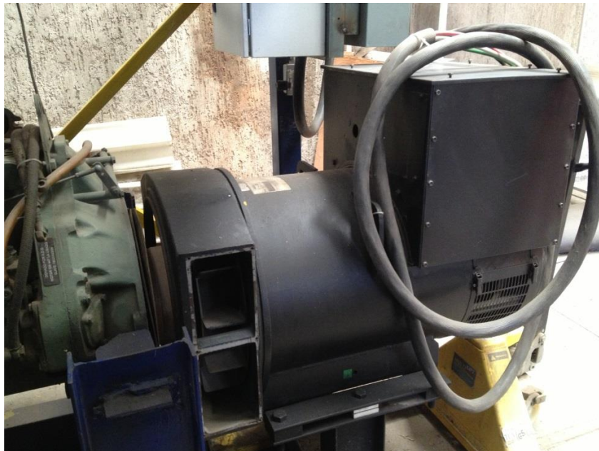
Figura 23. Vista del Generador eléctrico.
