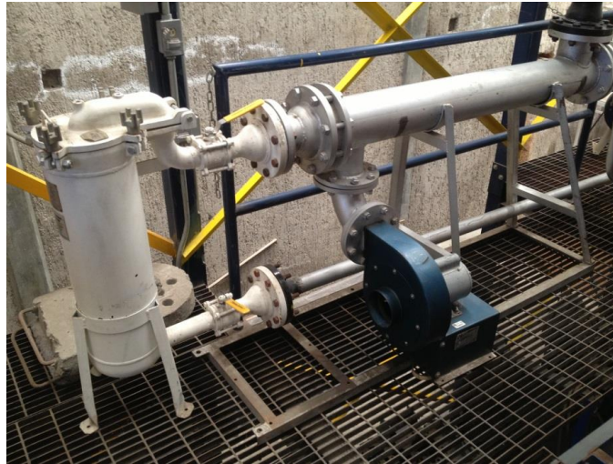
Figura 21. Vista del filtro y el soplador de aire
