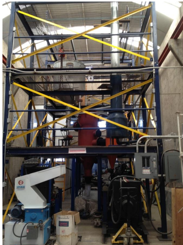
Figura 16. Vista frontal de la planta de gasificación.
