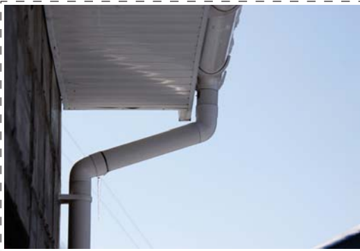
tubería de PVC
