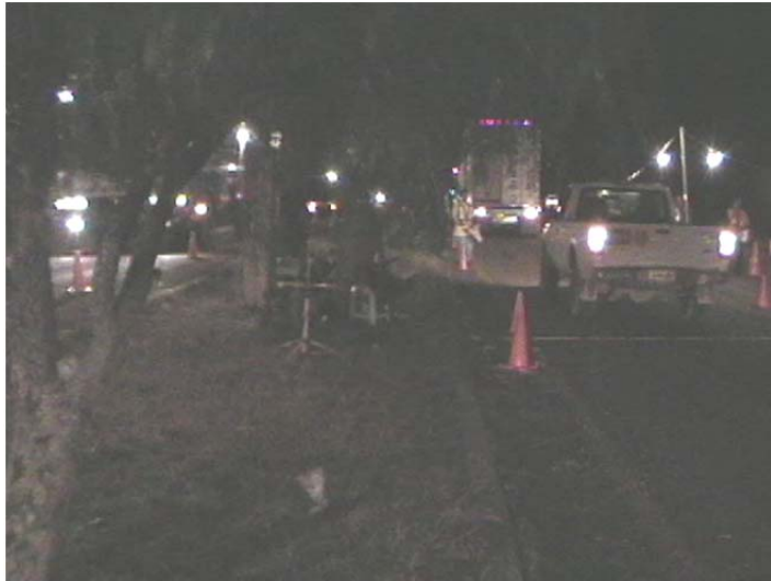
Estación OD Aeropuerto iluminación turno nocturno 04
