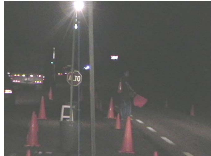
Estación OD Aeropuerto iluminación turno nocturno 03
