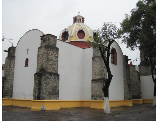
Figura 15 Presencia de humedad en los contrafuertes, Parroquia de San Bartolomé Apóstol (marzo, 2012)
