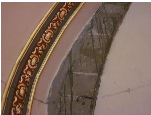
Figura 18 Esgurrimiento de resina en la zona del coro, Parroquia de San Bartolomé Apóstol (marzo, 2012)
