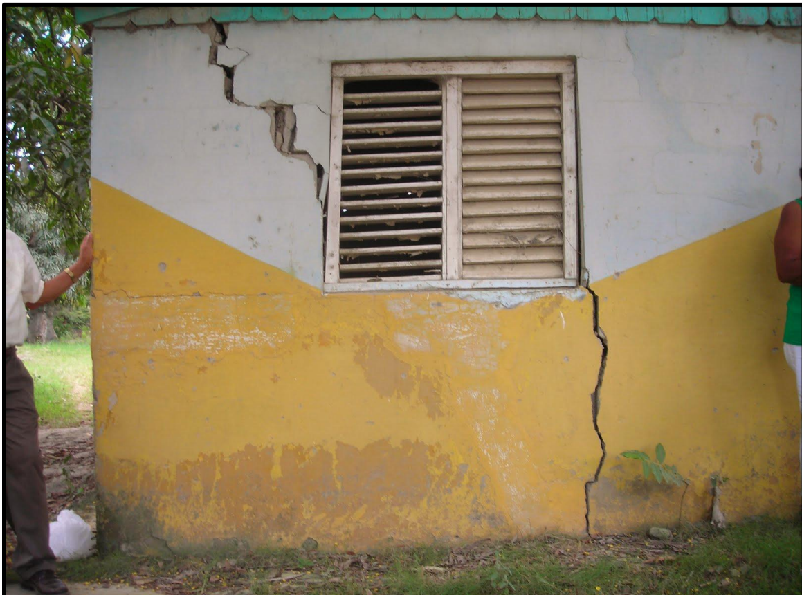
Figura 4.10.- Grieta producida por las vibraciones causadas por las maquinarias de una fábrica cementera localizada a pocos metros del lugar. República Dominicana.
