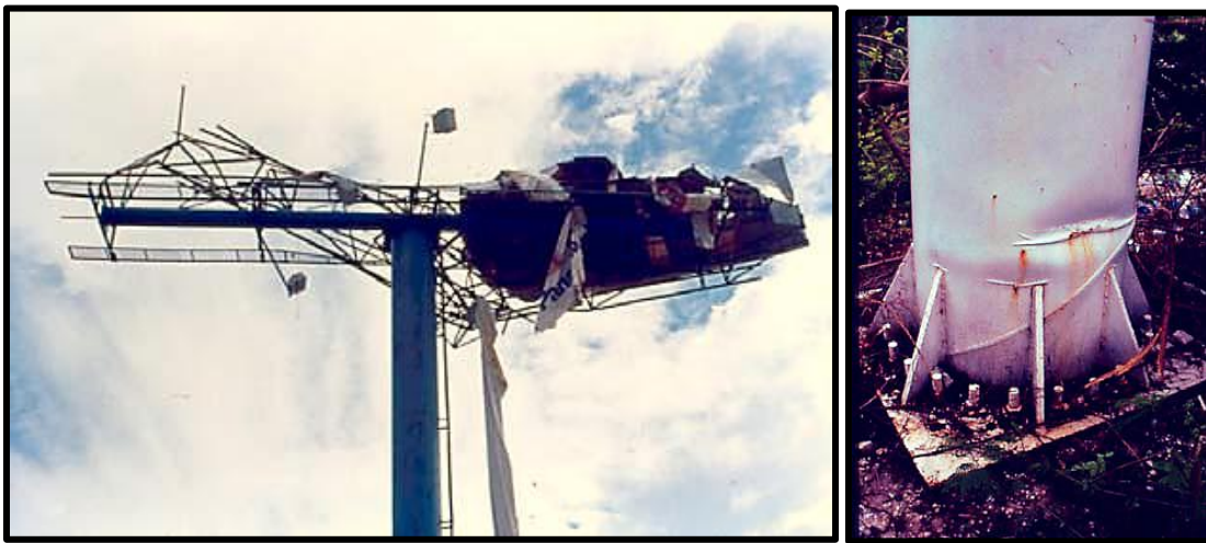
Figura 4.17.- Daños en mampara y en pedestal de espectaculares durante el paso del huracán Isidoro, Mérida Yucatán.
