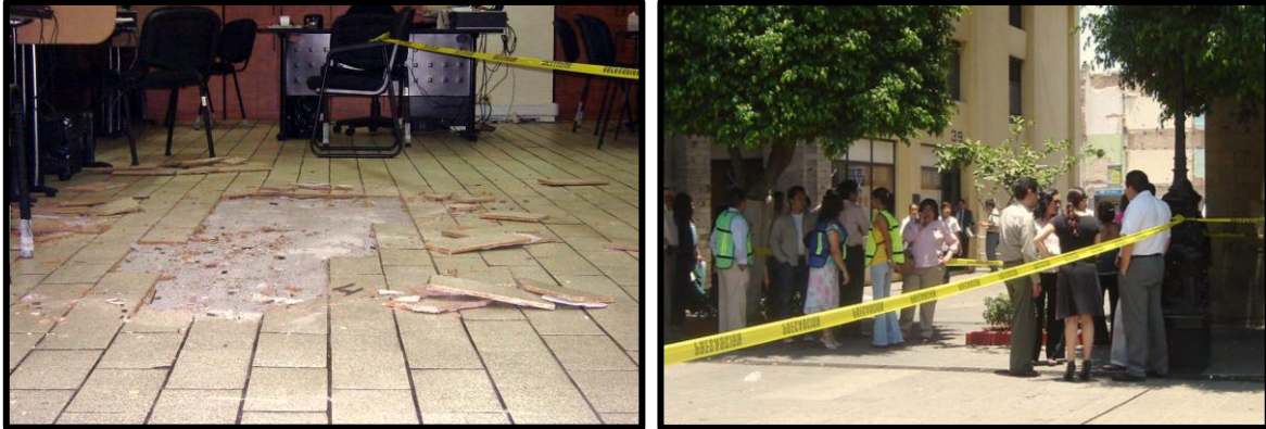
Figura 4.24.- Registro de agrietamiento en el primer piso de un edificio causado por las vibraciones producidas por el tráfico vehicular, provoco la evacuación de los trabajadores, Guadalajara Jalisco.
