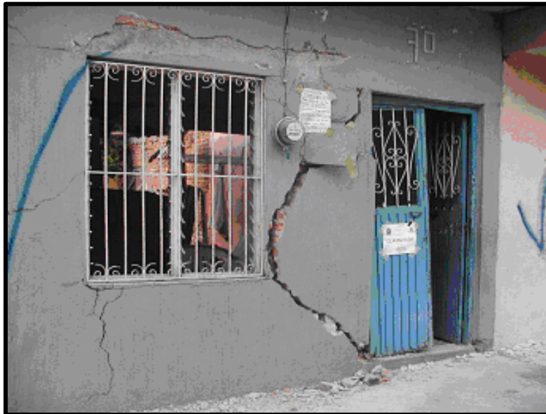
Figura 4.20.- Agrietamiento de muros en vivienda debido a un sismo, CENAPRED.
