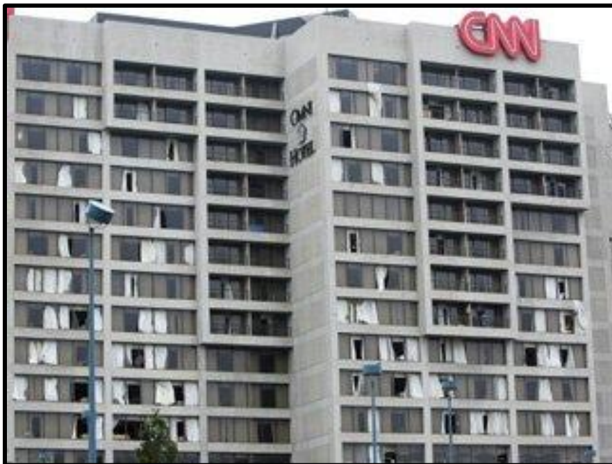
Figura 4.12.- Ventanas rotas en el edificio de CNN por fuertes vientos. Atlanta EE.UU.
