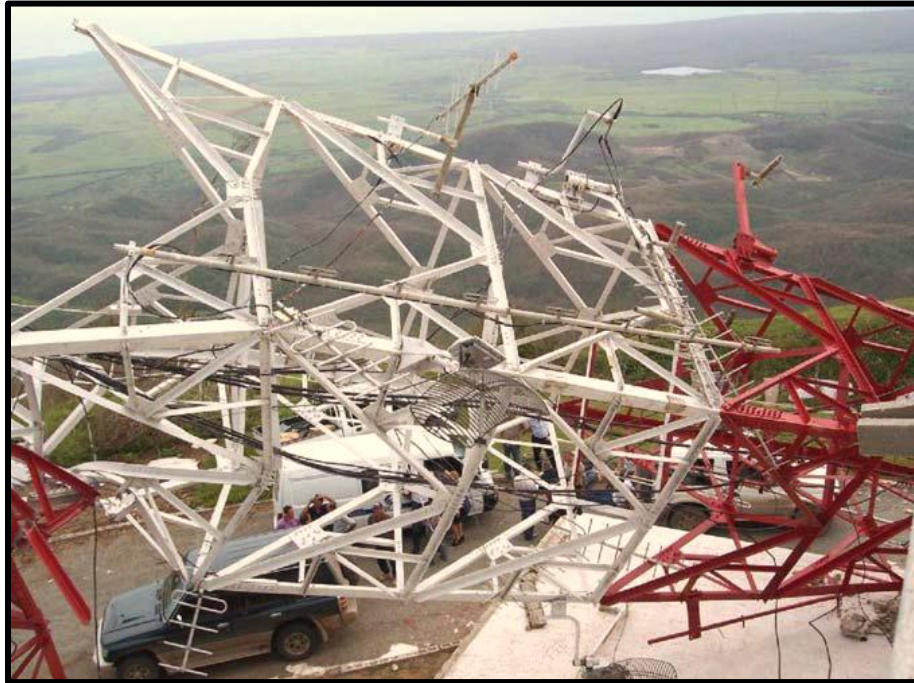
Figura 4.15.- Colapso de torre reticulada para comunicaciones ante el paso de un huracán, Cuba.
