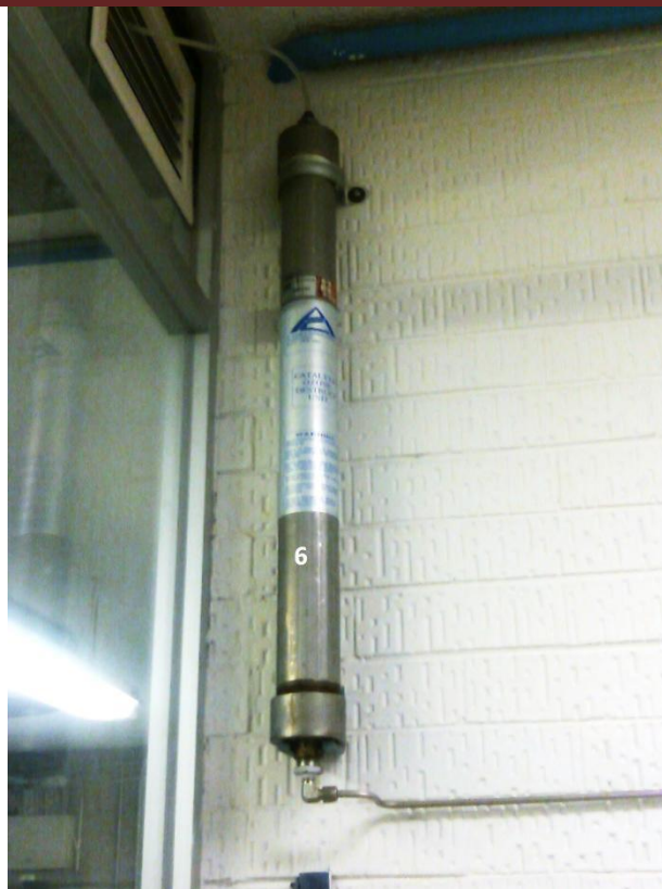
Figura 25 Equipo de ozonación Parte 5.
