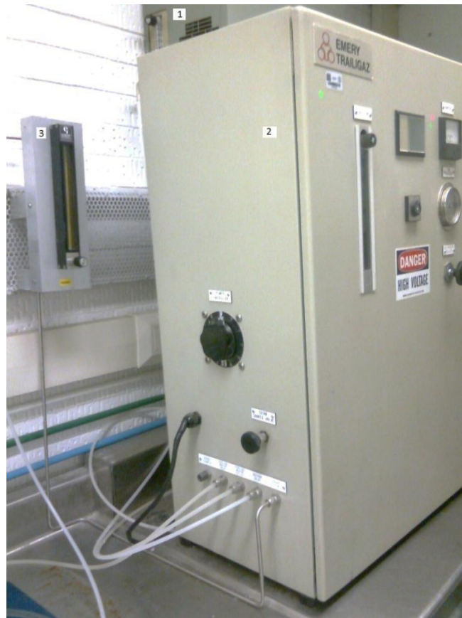
Figura 22 Equipo de ozonación Parte 2.
