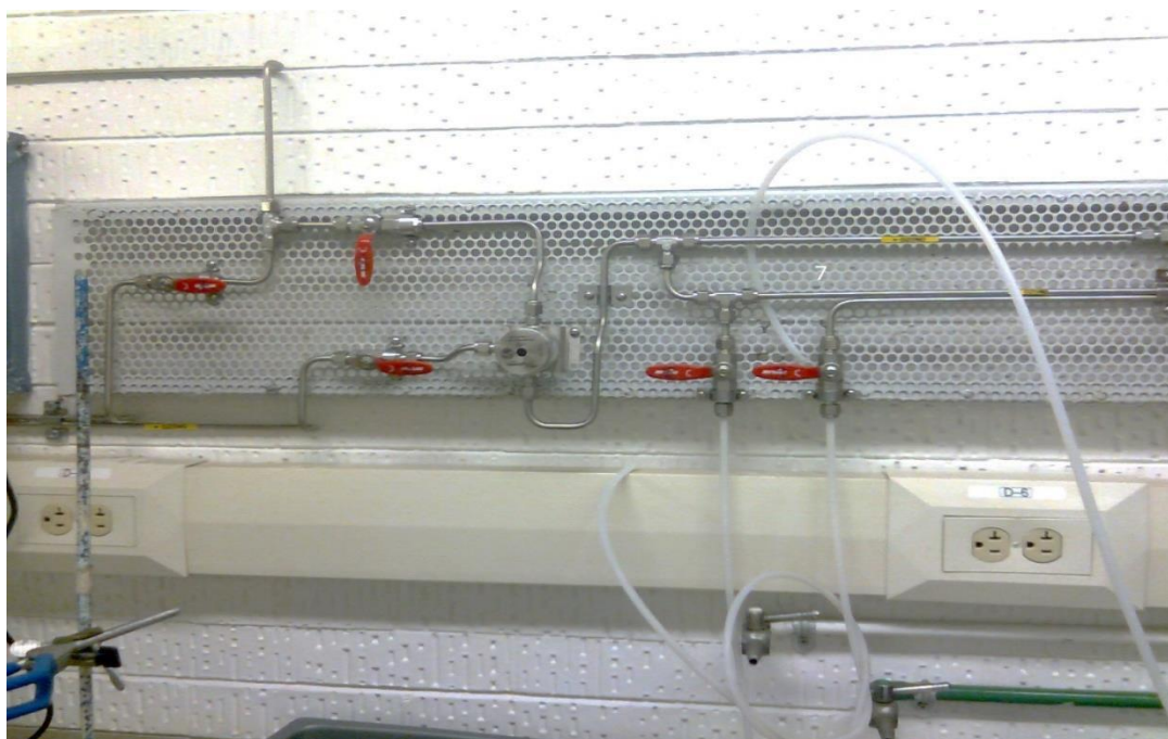
Figura 26 Equipo de ozonación Parte 6.
