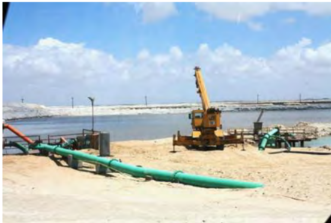
Fotografía 1. Navarro, E., Bombeo de agua de mar , Guerrero Negro, abril de 2010.
