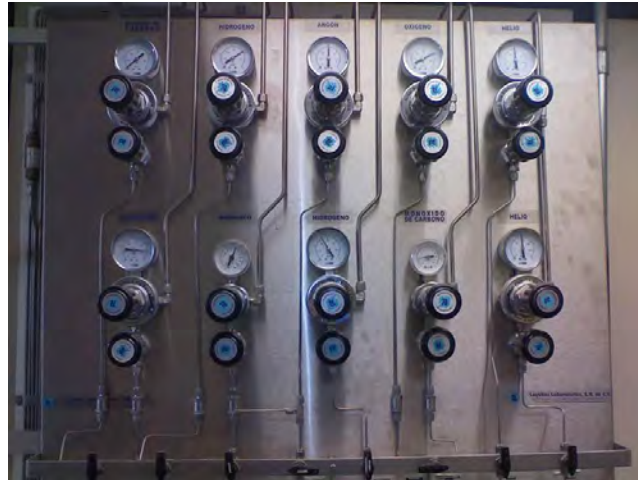
Figura 2.6 Rack de gases (Fuente: Propia)
