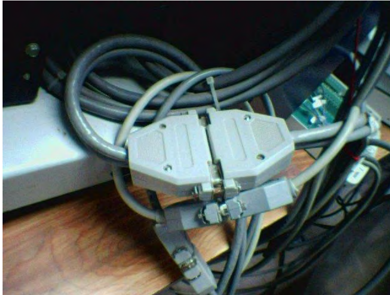
Figura 4.22 Conexión mediante DB15, DB25 y DB37 (Fuente: Propia)
