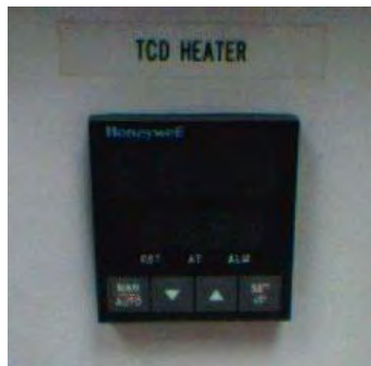
Figura 2.33 Control de Temperatura del TCD (fuente: Propia)
