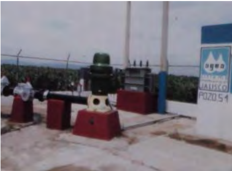
Pozo N° 54. Sistema Tesistán
