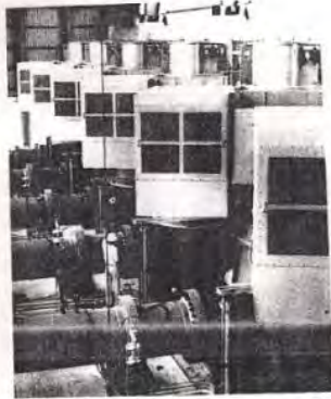
Conjunto de los motores eléctricos de la planta de bombeo y vista parcial de las tuberías de descarga.
