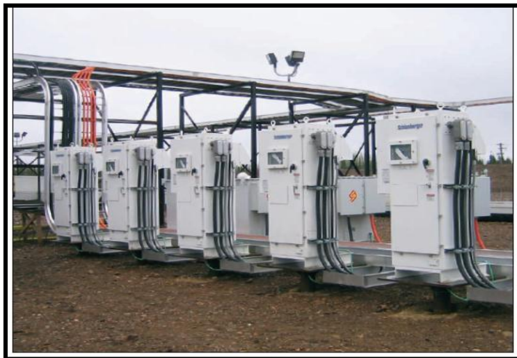
Figura 2.26 Variadores de Frecuencia
