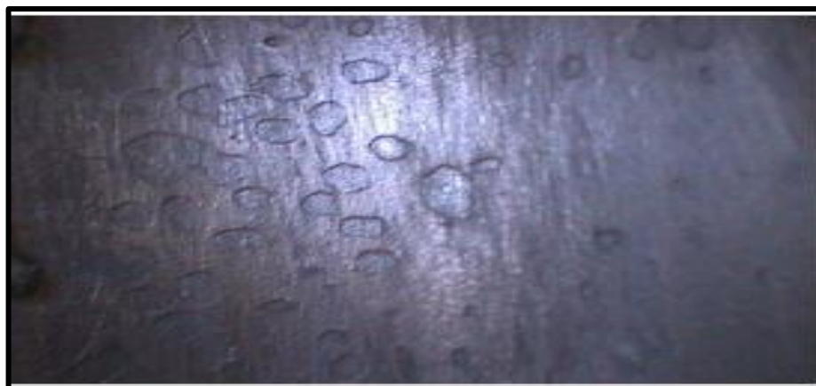
Figura 4.61 Azufre producto de la corrosión del acero al carbono
