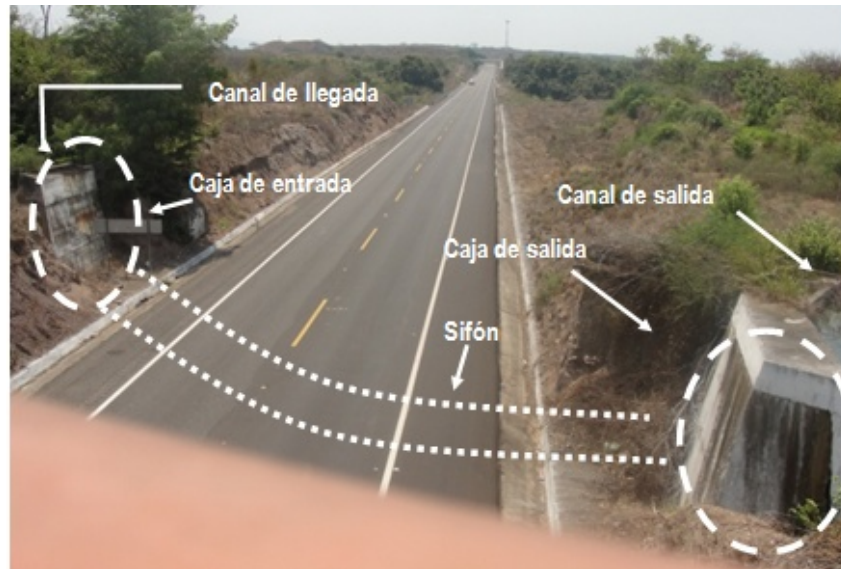
Fig. 28.-Foto de sifón funcionando en la carretera Lázaro Cárdenas, similar a nuestro caso.
