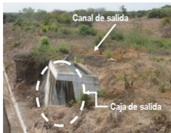
Fig. 29.-Salida del sifón donde el cruce del camino evita la continuidad del canal.
