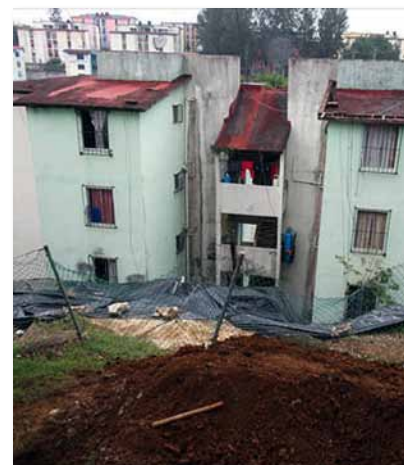
Figura 19. Conjunto de viviendas, las contenciones del terreno intervienen en el deterioro de la vivienda, Unidad Habitacional Nuevo Xalapa, 2010. Fuente: (imagen del autor)
