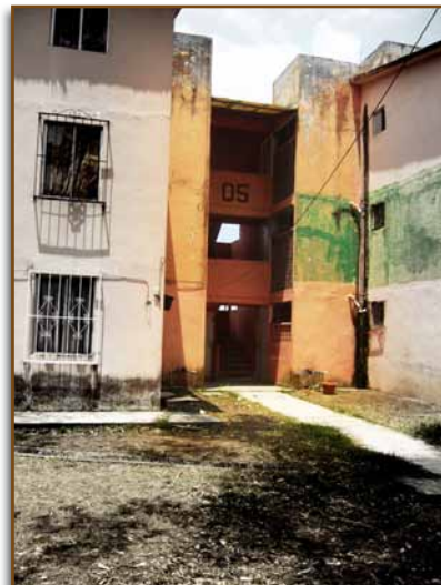
Figura 9. Conjunto de viviendas, en la imagen los usuarios contribuyen a remarcar las condiciones deterioradas interviniendo en mantenimientos diferenciados, que cada uno realiza de manera separada Unidad Habitacional Nuevo Xalapa, 2010. Fuente: (imagen del autor)
