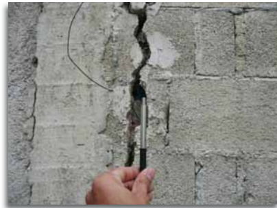
Figura 17. Grietas sobre muro con separación de material debido a asentamiento o movimiento estructural, (Fuente: Pablo Lopez Luz http://ingnavafernandez.wordpress.com/#wpcom-carousel-36 )
