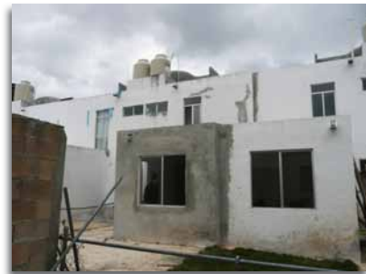
Figura 18. Grietas visibles por defecto de construcción, (Fuente: Pablo Lopez Luz http://ingnavafernandez.wordpress.com/#wpcom-carousel-36 )
