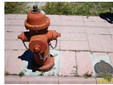
TOMA DE AGUA BOMBEROS CON REGISTRO DE AGUA.
