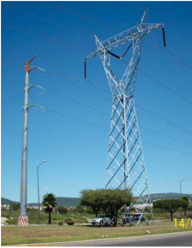
TORRES DE ALTA TENSIÓN EN EL CAMELLÓN AL SUR DEL TERRENO Y SOBRE LA ACERA DEL MISMO TERRENO.
