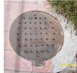
REGISTRO DE AGUA.
