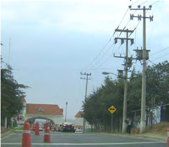
Imagen 3.4 Postes con transformadores en el acceso a Condado de Sayavedra
