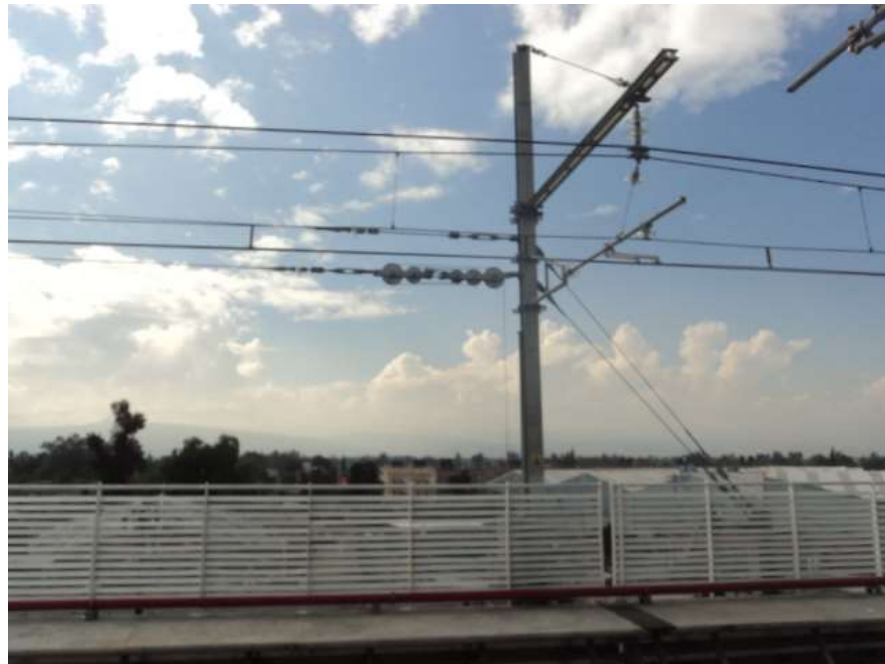
Sistema de catenaria flexible utilizado en Línea 12.
