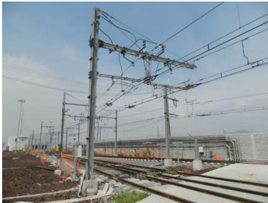
Sistema de catenaria flexible utilizado en Línea 12.
