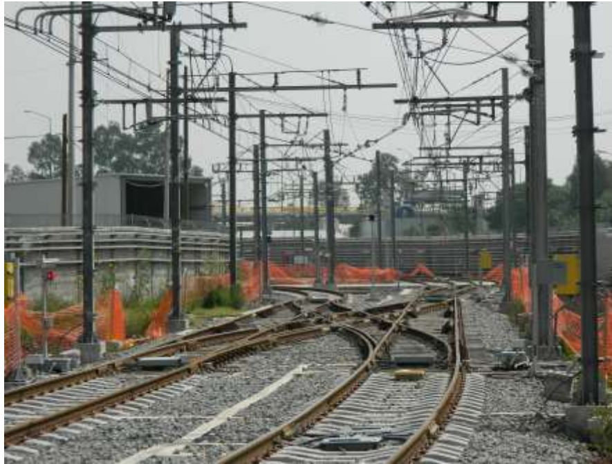
Aparatos de cambio de vía.
