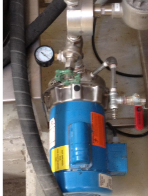
Figura 6.5 Bomba de crudo (GA-01).
