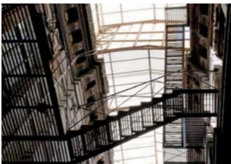
Fig. 699. Una imagen que exalta el intrincado enjambre de hierros de la escalera de servicio del actual Museo de Geología. Foto: RV, 2008
