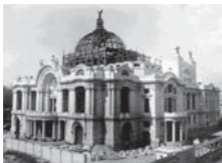
Fig. 992 y 993. El Palacio de Bellas Artes en construcción. Foto: F. Miret, 1907 (arriba); C.I.F., 1922 (abajo), en: AGN, Fondo: Instrucción Pública y Bellas Artes; Serie: Propiedad Artística y Literaria; Tema: ciudad de México; inv. núm. 2 (arriba); núm. 126 (abajo)
