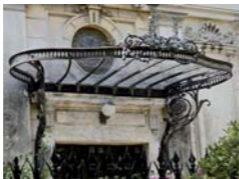
Fig. 908. La Casa Cámara de Mérida, arq. Umbdenstock, ing. Manuel Cantón Ramos. Foto: RV, 2011
