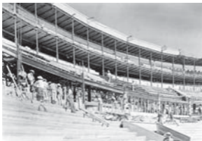
Fig. 900. El Toreo de Cuatro Caminos en construcción, 1956 Foto: Luis Márquez Romay, Fototeca IIE-UNAM
