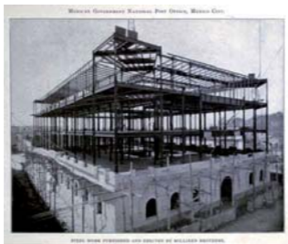
Fig. 67. Una lámina del catálogo de Milliken Bros. New York de 1905, con una fotografía del edificio del Correo de la ciudad de México durante su construcción
