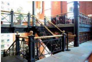
Figs. 544 y 545. Dos imágenes de la escalera de hierro fundido de la antigua sala de cocimientos, en la Cervecería Cuauhtémoc, Monterrey, 1890 ca. Foto: RV, 2008
