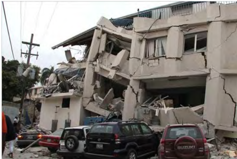
Figura 3.4 Daños en estructura.
