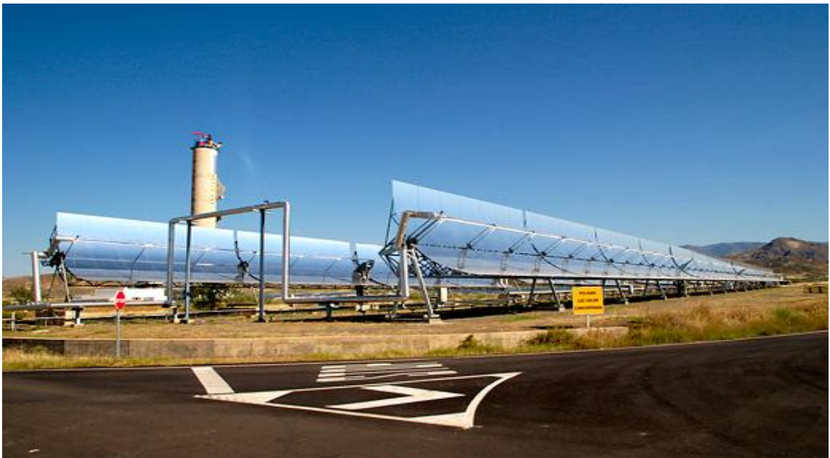
Figura 3.12.- Campo solar con colectores cilíndrico-parabólicos de seguimiento solar.
