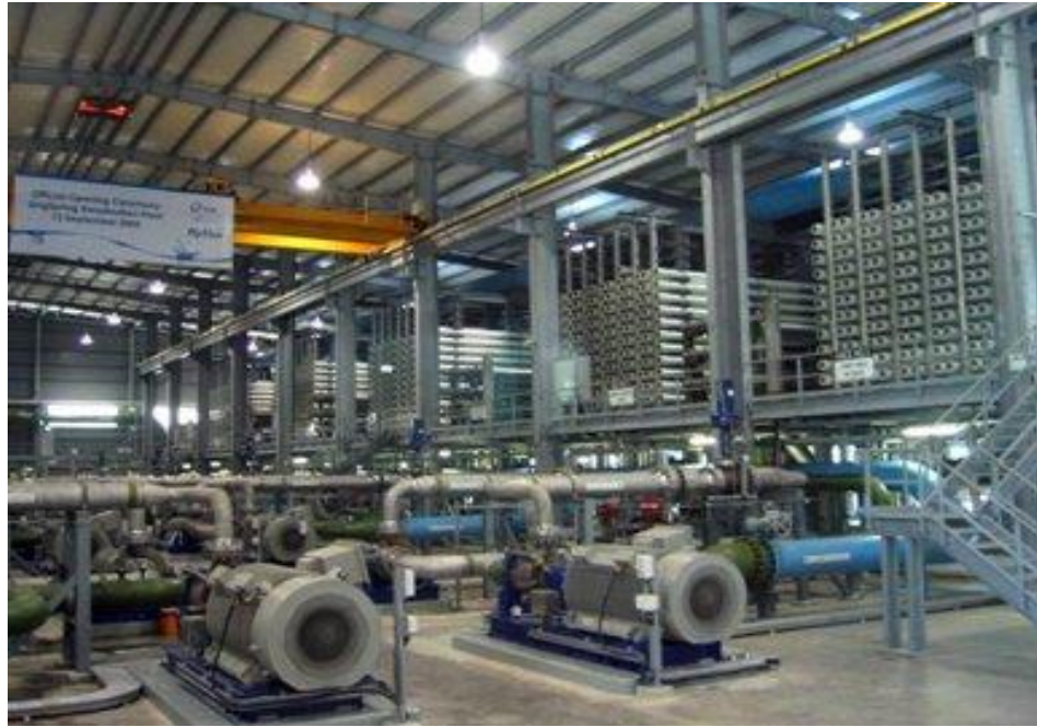
Figura 3.15.- Planta desaladora de Ósmosis inversa en Singapur, para agua de mar.
