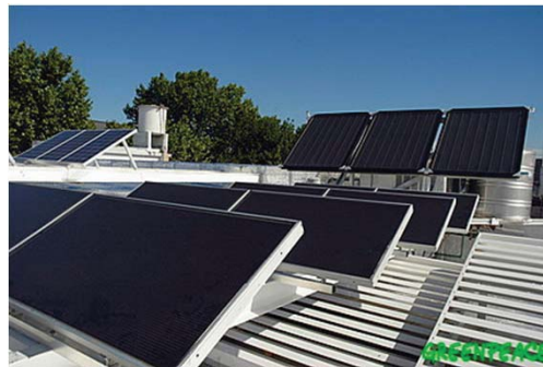
Img. 13 Paneles Solares.
