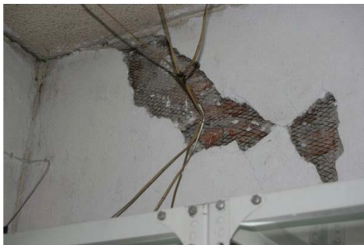
Img. 3 Deterioro de acabados
