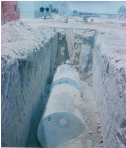
Img. 11 Filtros sanitarios
