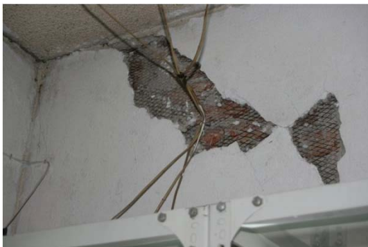
Img. 3 Deterioro de acabados
