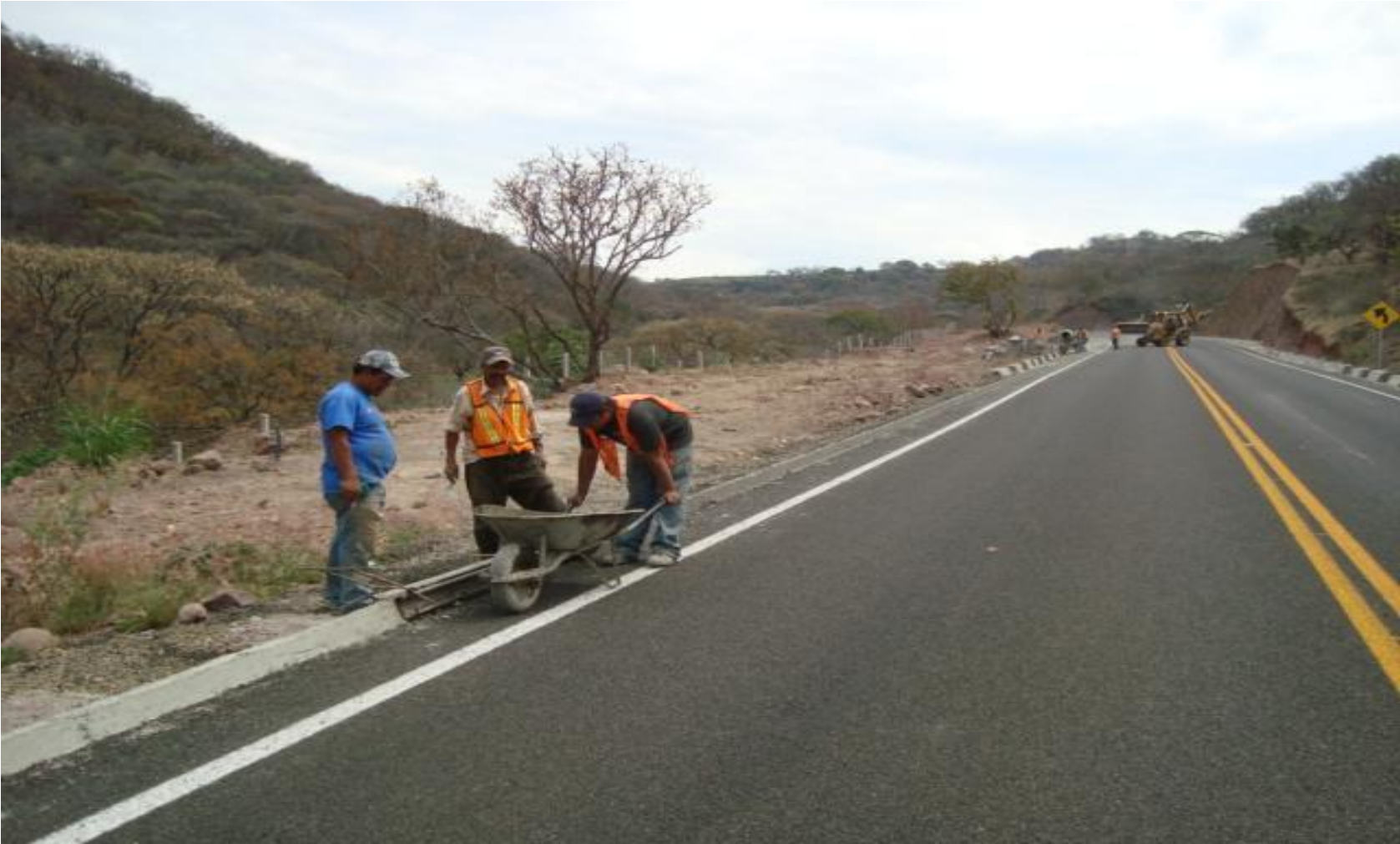
COLADO DE GUARDAS LATERALES PARA CONDUCIR EL AGUA DE LLUVIA A LAS CUNETAS O LAVADEROS
