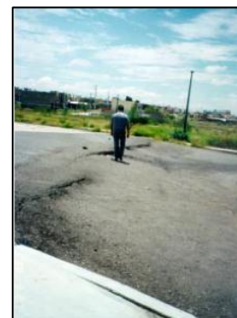
Figura 1.16. Hundimiento diferencial y agrietamiento del subsuelo de la ciudad de Aguascalientes, causados por la sobreexplotación de acuíferos. Fuente. CENAPRED
