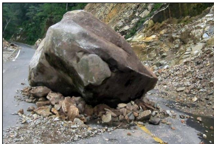
Figura 1.14. Ejemplo de caídos de roca en una carretera del municipio de Tecpan de Galeana, Guerrero. Agosto, 2011. Fuente: El Diario de Zihuatanejo.
