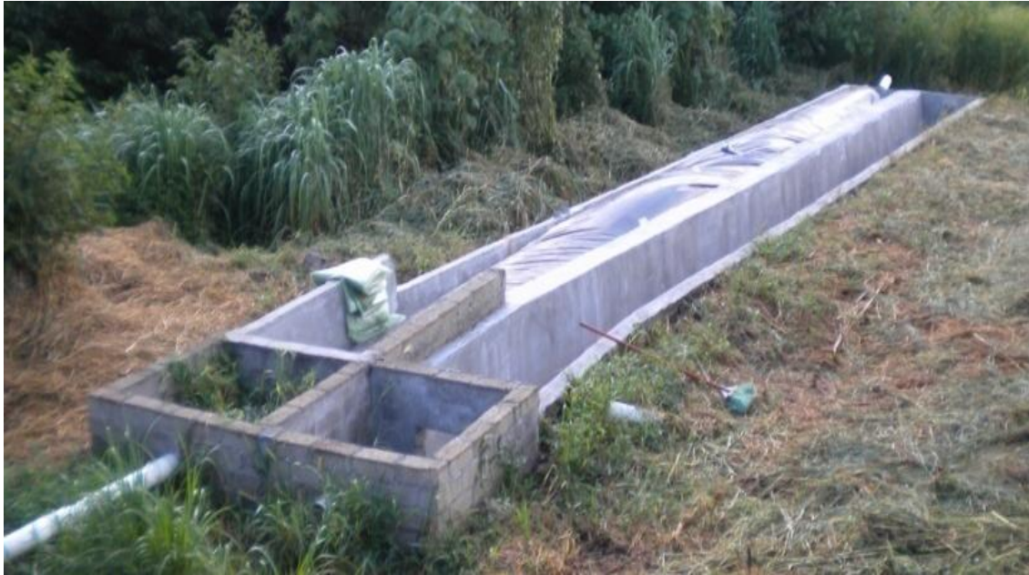
Figura 9. Biodigestor anaerobio tubular de 15 m 3 . Apaxtla de Castrejón, Guerrero.
