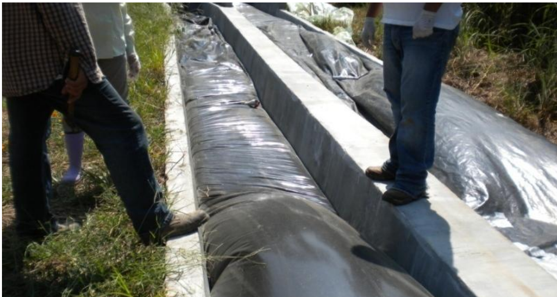
Figura 2. Sistema de tratamiento anaerobio de aguas residuales dentro de una granja porcícola. Apaxtla de Castrejón, Guerrero.
