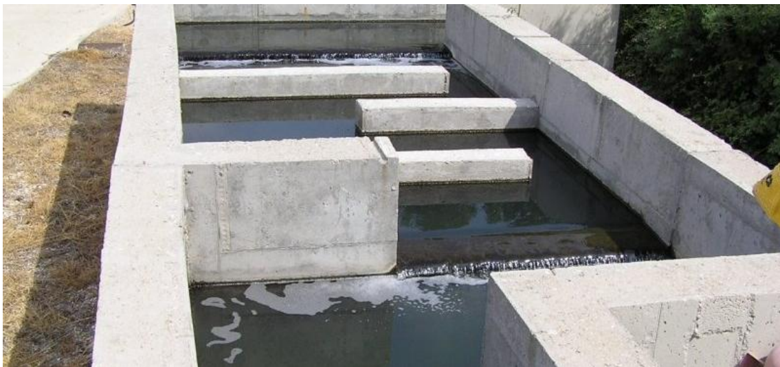
Figura 5. Canal de cloración. Tomado de Estadísticas del Agua en México, CONAGUA, 2010.
