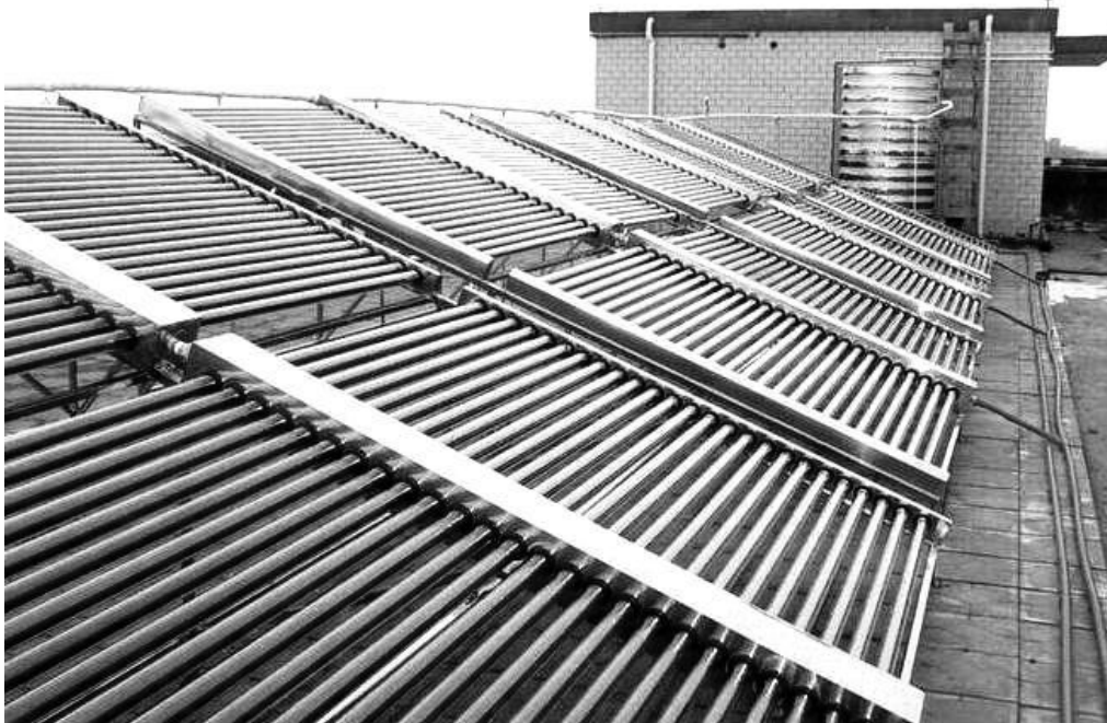
Fig.4.10. Se muestra como quedaran interconectados los equipos
