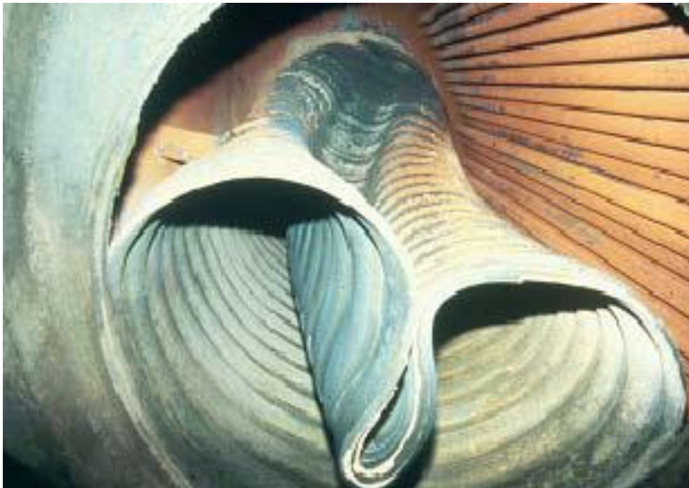
12 Imagen. 1.10. Hogar de una caldera pirotubular deformado por efecto de una falla en el control de nivel.
