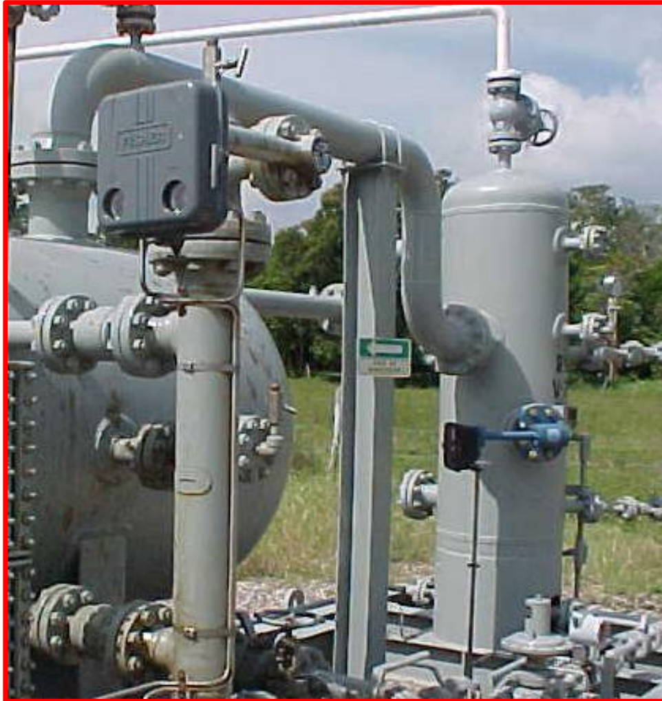
Fig. 2.2.- Rectificador de gas. Fuente: ENX Compressors
