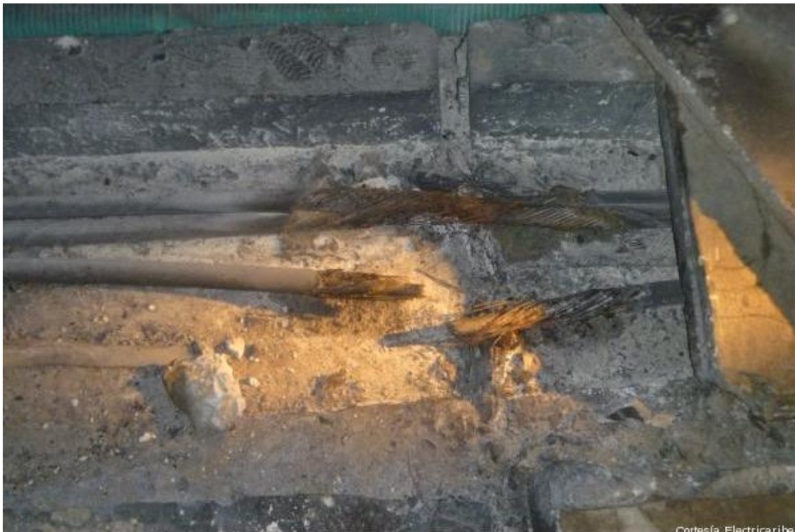
Figura A.1.- Falla trifásica debida al intento de robo de cables en un sistema de media tensión.
