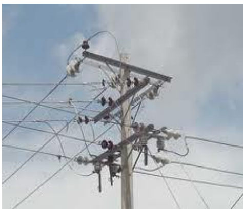
Figura F.3.- Conductores a la intemperie
