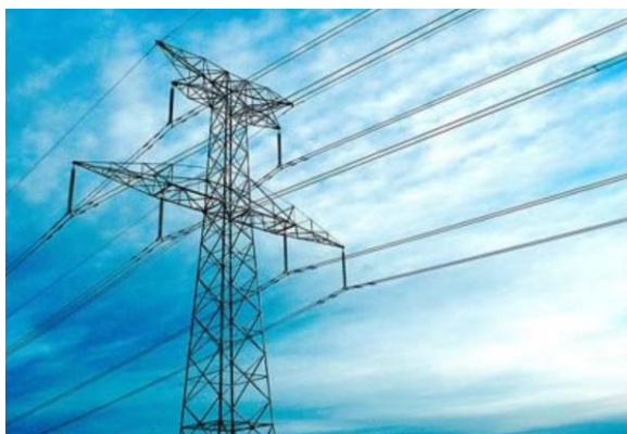
Figura F.1.- Red eléctrica aérea
