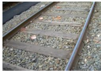
Durmientes de madera
