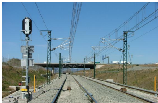
Figura 2.61. Catenaria tendida sobre una vía.
