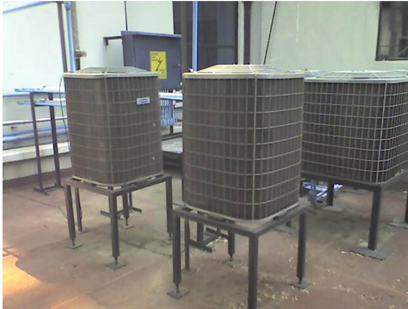
Imagen 7.4.3 Espacio a liberar para las nuevas Unidades Condensadoras.
