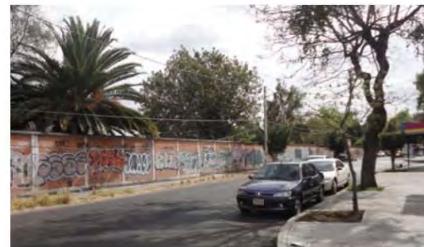
Calle de Museo, barda de colindancia en mal estado.
