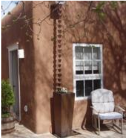
Fig. 33 Remodelación de una casa en Nuevo México con implementación de sistemas de captación de agua de lluvia entre otras ecotecnias. En la figura se aprecia una cadena de agua que sirve para conducir el agua de una gárgola al depósito.
