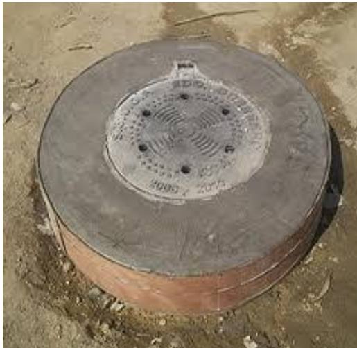
Servicio de Agua Potable Foto 95
