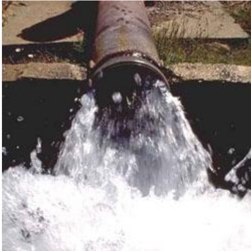
Servicio de Agua Potable Foto 94
