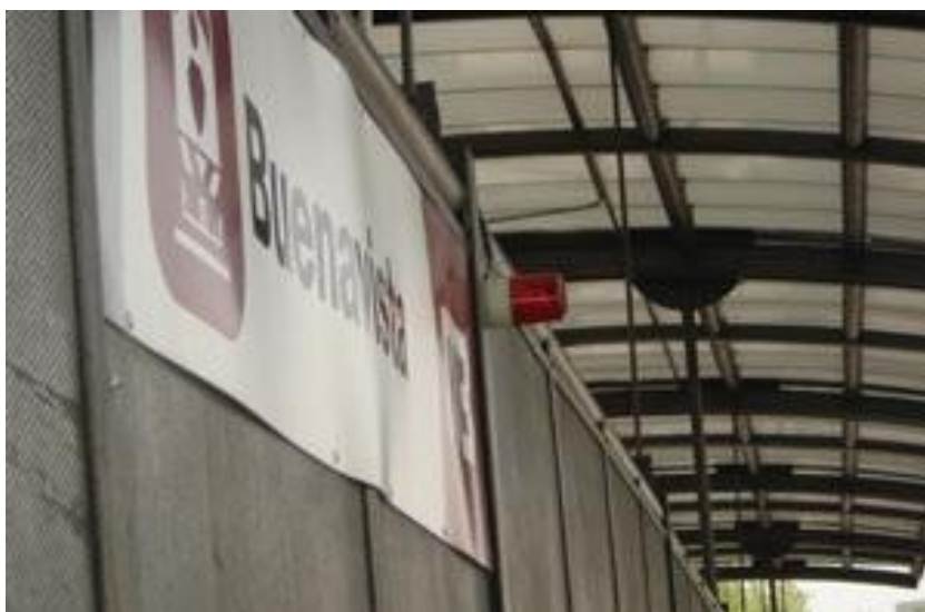
Imagen 22. Vista de la sirena que da aviso al conductor de que espera una persona con discapacidad, en esta foto se ve la estación Buenavista.
