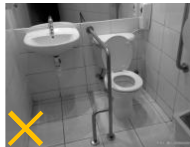
FIG. 28 La barra fija al piso impide acercarse al wc y al lavamanos, mala distribución de artefactos y espacio insuficiente.
