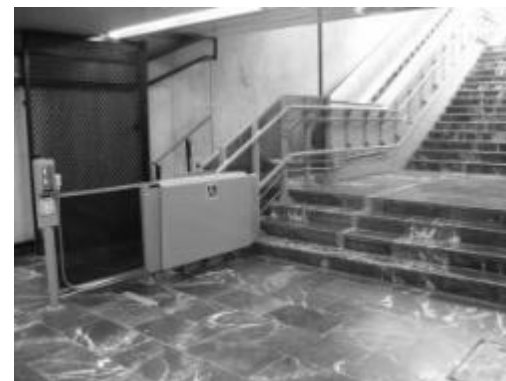
FIG. 58 Plataforma salva escaleras en el Sistema de Transporte Colectivo Metro.
