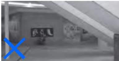
FIG. 199 Circulación bajo escaleras sin protección.
