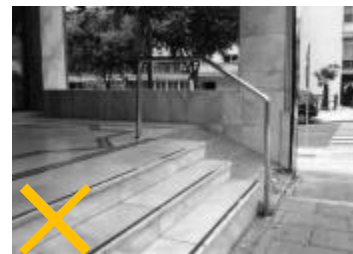
FIG. 23 Rampa con pendiente pronunciada, a pesar de tener suficiente espacio para más desarrollo de la misma.
