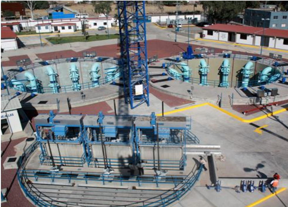
CÁRCAMO DE BOMBEO LA CALDERA. ESTADO DE MÉXICO
