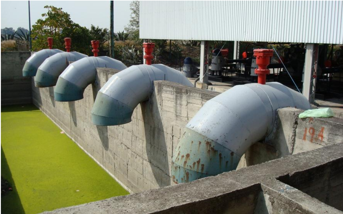
Fotografía 11 Estructura de descarga de la planta de bombeo existente
