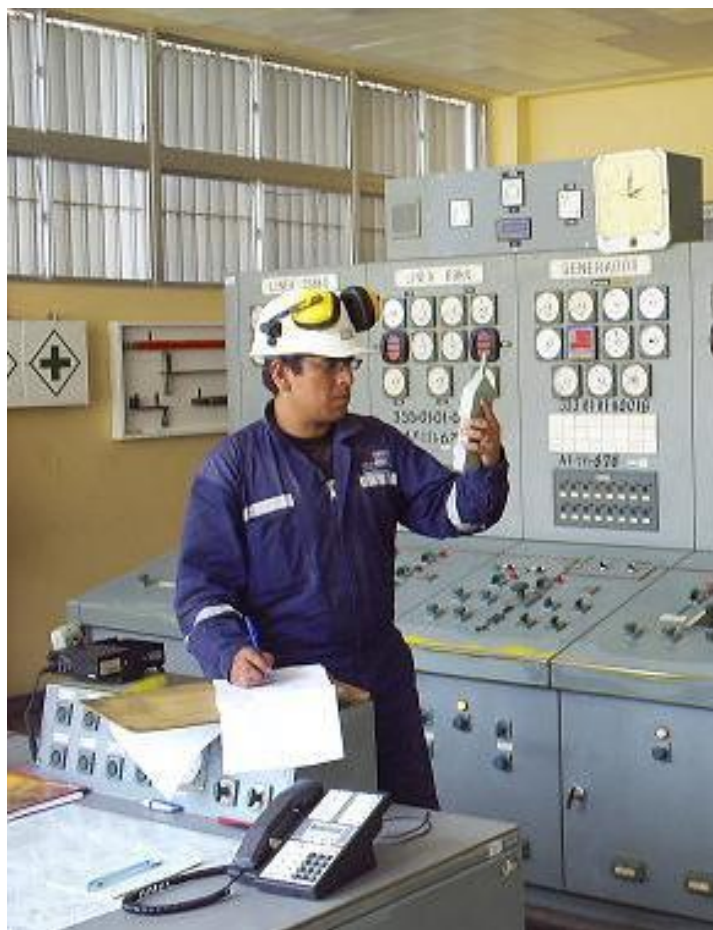
Figura 1. Ingeniería y Proyecto. Diagnósticos Energéticos. Adaptado del portal: http://www.plantasdelluzmexico.mx/diagnosticos_energeticos_ahorro_de_energia.html
