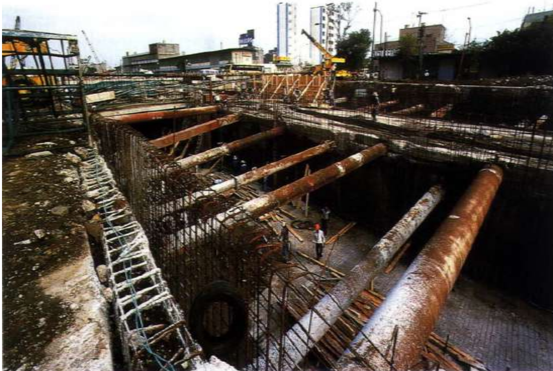
Figura 4. Troquelamiento de los muros en tramo sección cajón subterráneo. Fuente: Grupo ICA 1997.
