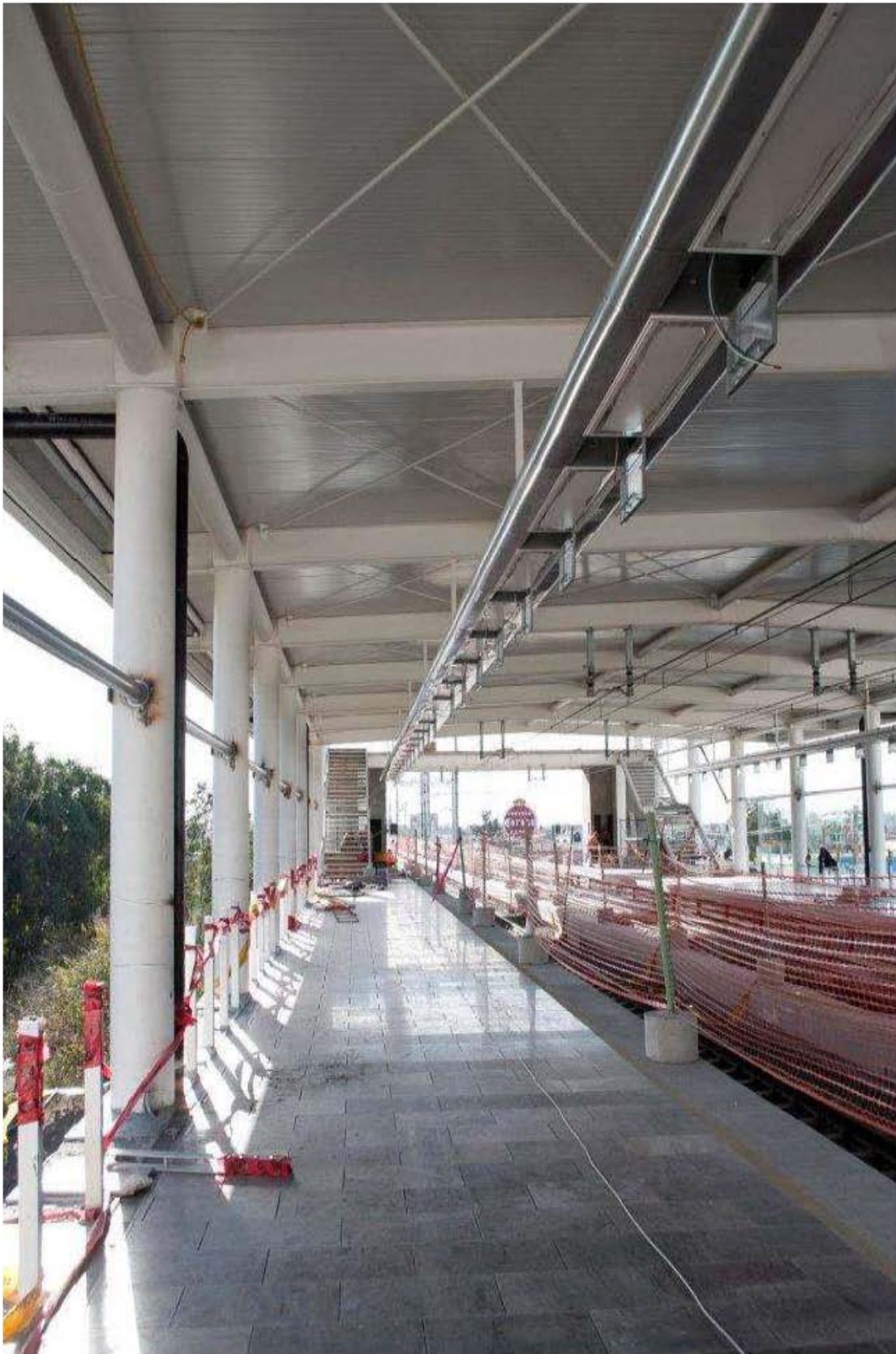
Figura 32. Luminarias para enfatizar borde de andén.
