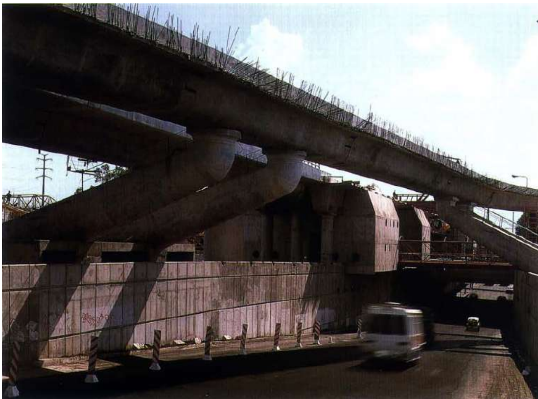
Figura 7. Viaducto elevado en línea B del metro. Fuente: Grupo ICA, 1997.
