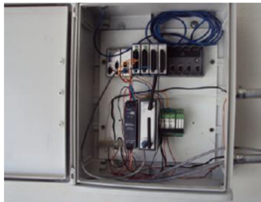
Fig. 5.8 Fotografía Control Sistema de Refrigeración
