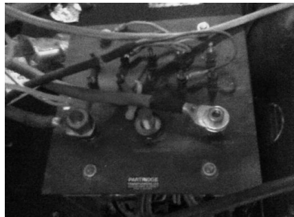
Figura 4.7. Conexiones al transformador.
