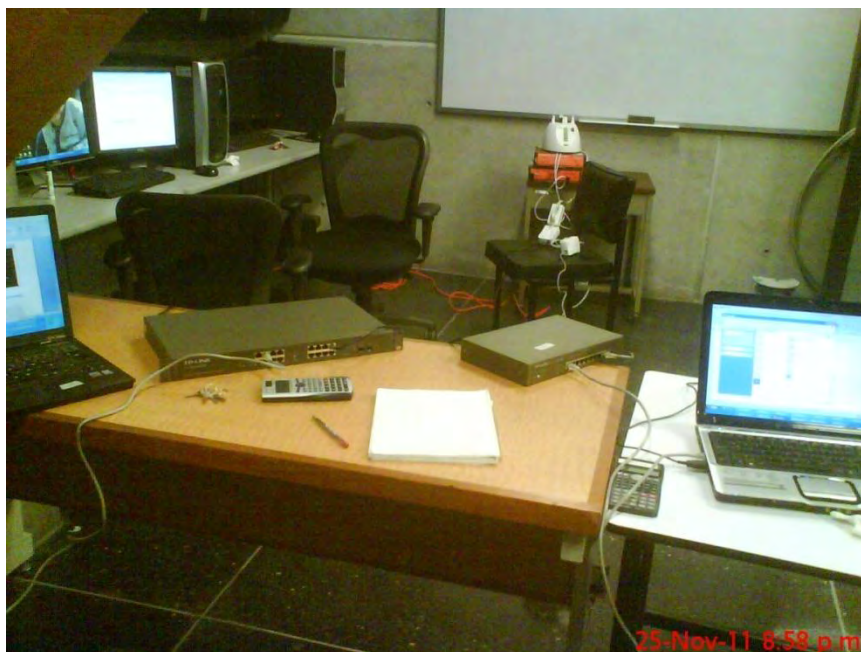
Figura 3.15 Implementación física de la topología punto a punto de la red utilizando PLC
