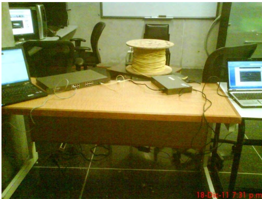
Figura 3.6 Implementación física de la red de Fibra Óptica con un cliente y un servidor
