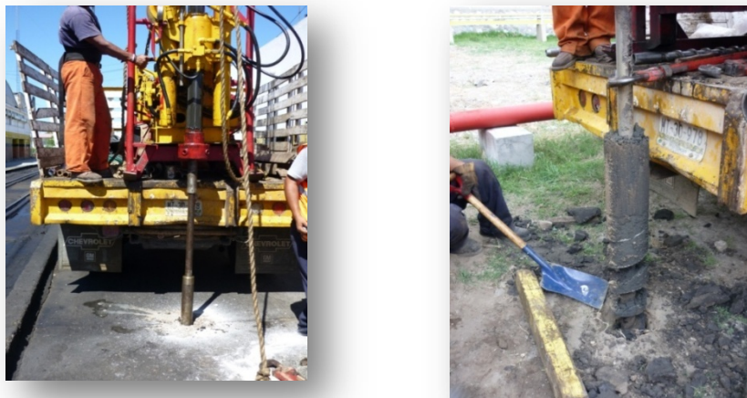
Figura 5.2 Toma de muestra con el equipo Long Year
