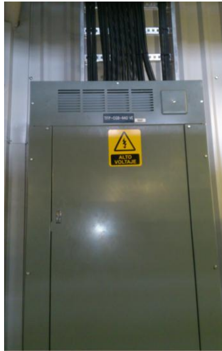
Fig. 2.4 Tablero de fuerza, equipos y proceso Fuente: Tecnofarma Planta San Juan del Rio Qro.
