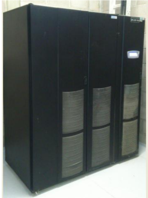
Fig. 2.8 Sistema UPS (en inglés Uninterruptible Power Supply) Fuente Ininterrumpida de Poder Fuente: Tecnofarma Planta San Juan del Rio Qro
