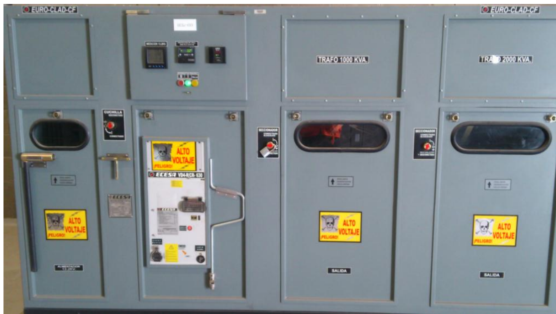
Fig. 2.1 Subestación tipo interior Fuente: Tecnofarma Planta San Juan del Rio Qro.
