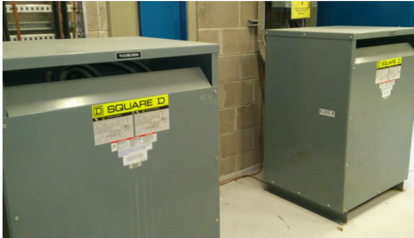
Fig. 2.6 Transformadores, 440 a 220 y 127 V. Fuente: Tecnofarma Planta San Juan del Río Qro.
