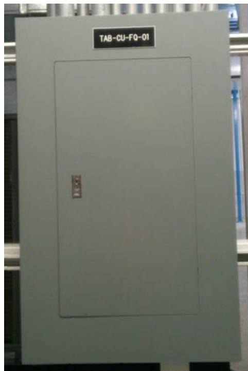
Fig. 2.9 Tablero de contactos UPS. Fuente: Tecnofarma Planta San Juan del Rio Qro
