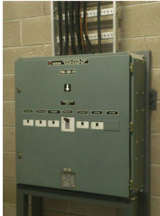
Fig. 2.10 Tablero de distribución UPC Fuente: Tecnofarma Planta San Juan del Rio Qro
