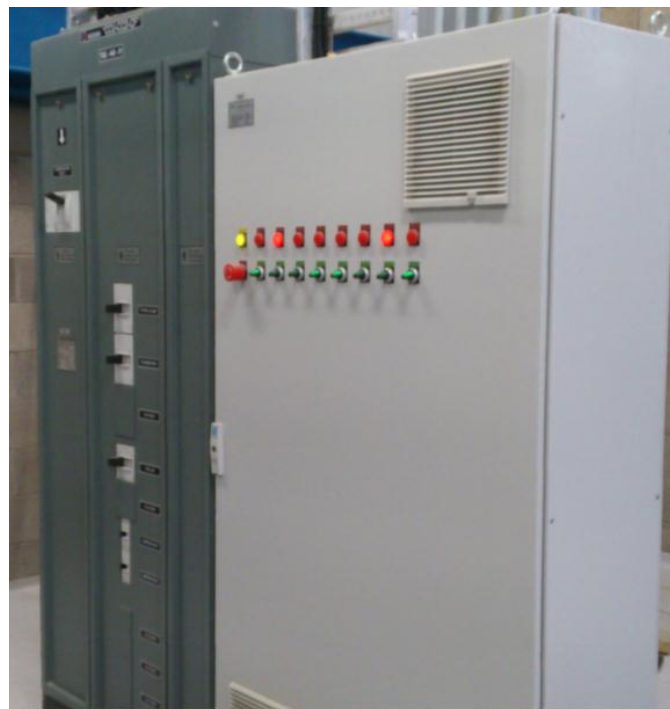
Fig. 2.7 Sistema de control de motores Fuente: Tecnofarma Planta San Juan del Río Qro.
