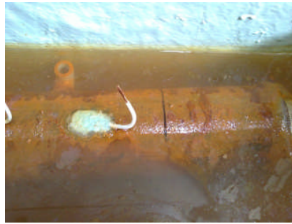
Fotografía 1.1 Metal sumergido en agua salada gravemente corroído.
