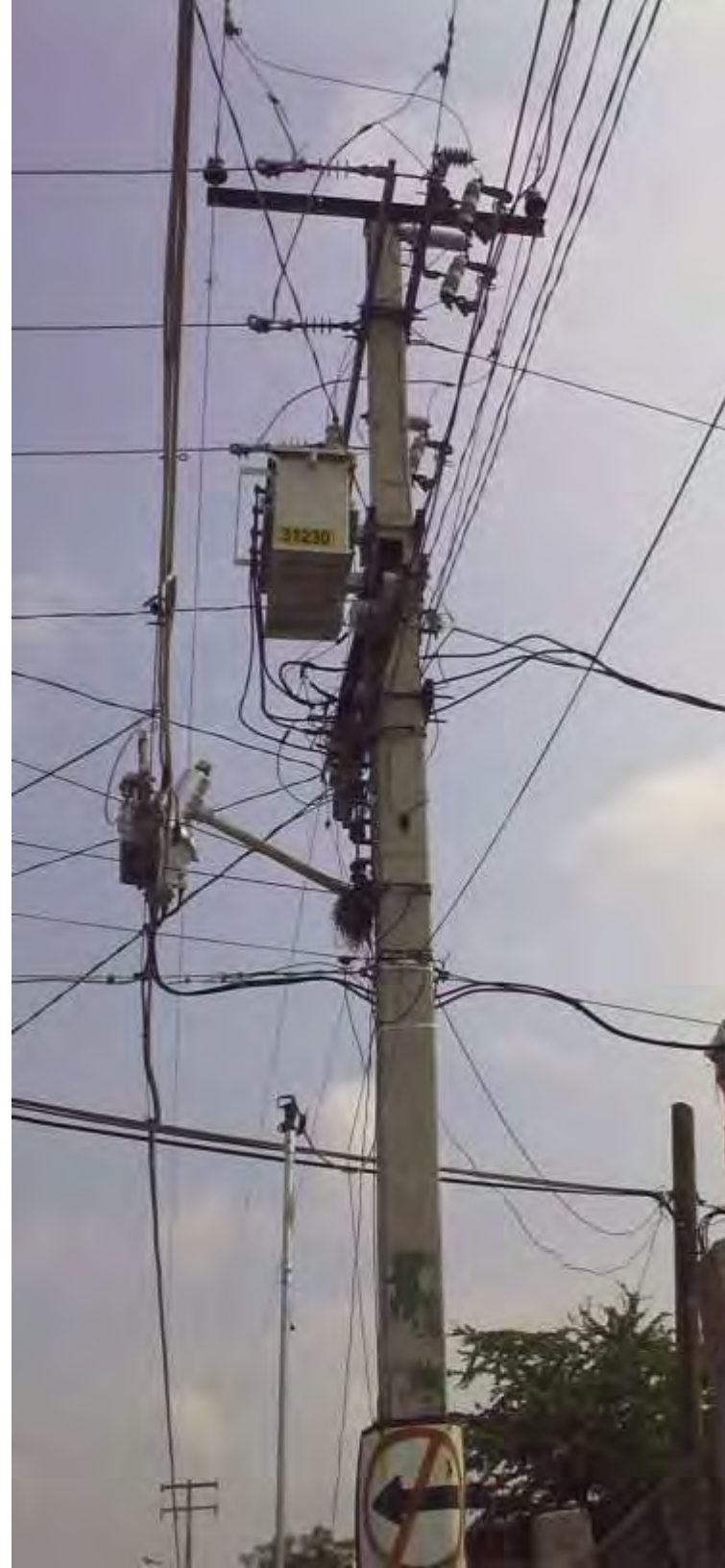
Fig. 56 Poste con transformador y conexiones ilegales
