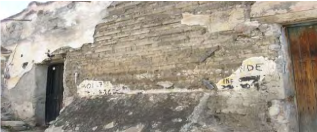
Fig. 69 Deterioro visual en vivienda
