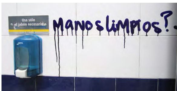
Foto 2. Imagen tomada en los sanitarios de la escuela. Seguimos observando que las actitudes se ven desde el cuidado de las instalaciones por parte de los alumnos ya que no cuidan, ni respetan su espacio de estudio.
