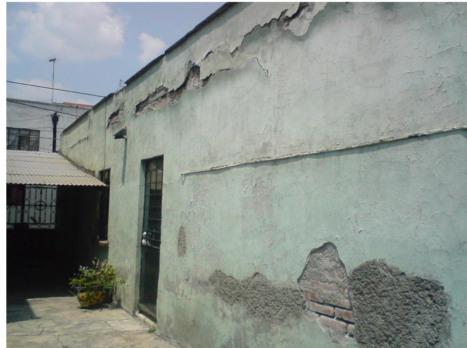
Se encuentra muy deteriorada debido a la falta de mantenimiento y antigüedad de más de 70 años
