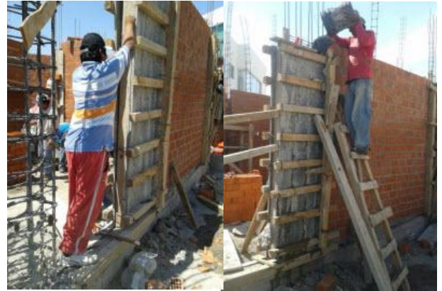
Para el colado de castillos se usa un concreto de resistencia F'c=150 \text{ Kg./cm}^2 .
