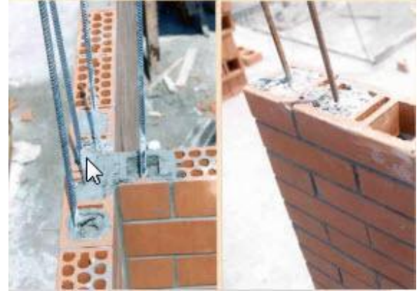
Para ahogar los castillos se utilizan los ladrillos HUECOS, que a su vez nos permite un ahorro al no necesitar cimbra.
