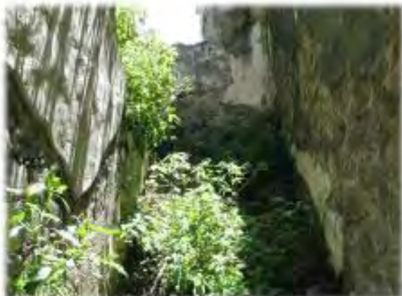
16.- VISTA DE ESCALERAS QUE CONECTABAN LA SACRISTÍA CON CELDAS EN LA PARTE ESTE DEL CONVENTO.
