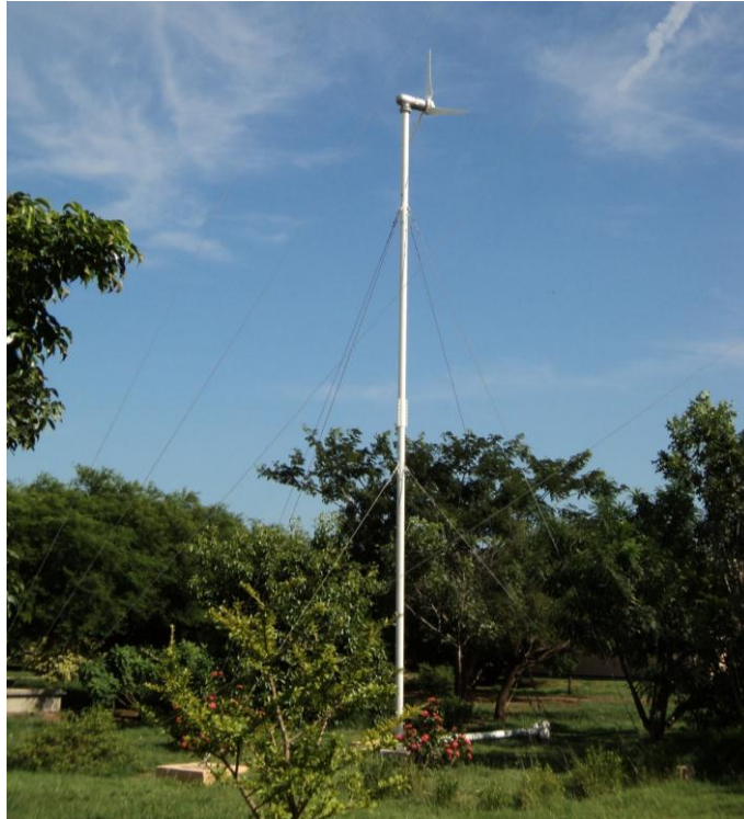
Figura 4-3. Aerogenerador ubicado en la torre de prueba de la UNISTMO.
