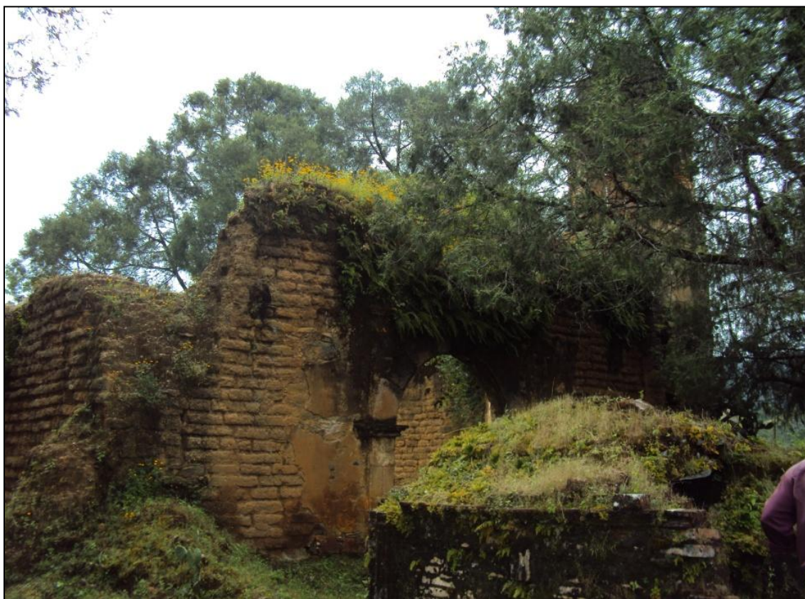
Figura 19. Ruinas de cementerio en Mina de Agua, San Simón de Guerrero.
