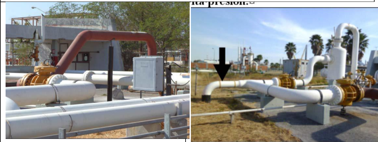
Línea de llegada de gasoducto de 12" alta presión.
