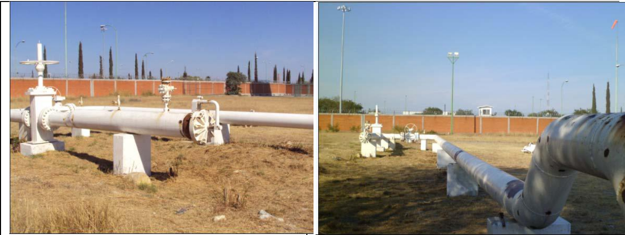
Punto de interconexión de trampa de recibo de diablos.
