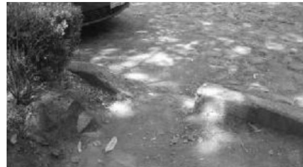
Problemas de accesibilidad y deterioro en infraestructura
